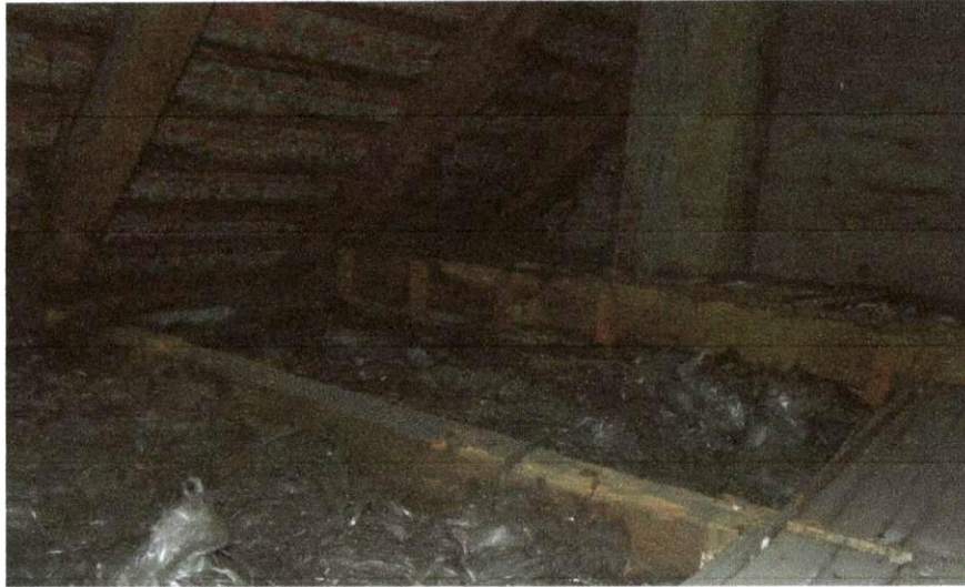
Widok uszkodzonych belek stropowych, brak podłogi i nieprawidłowo wypełniona przestrzeń międzybelkowa
