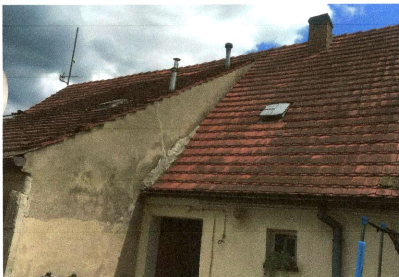
Brak obróbek blacharskich i wiatrownicy powoduje podrywanie dachówek i zamakanie ścian
