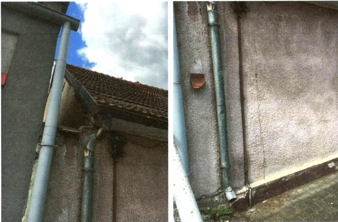
Wadliwe odprowadzenie wód opadowych
